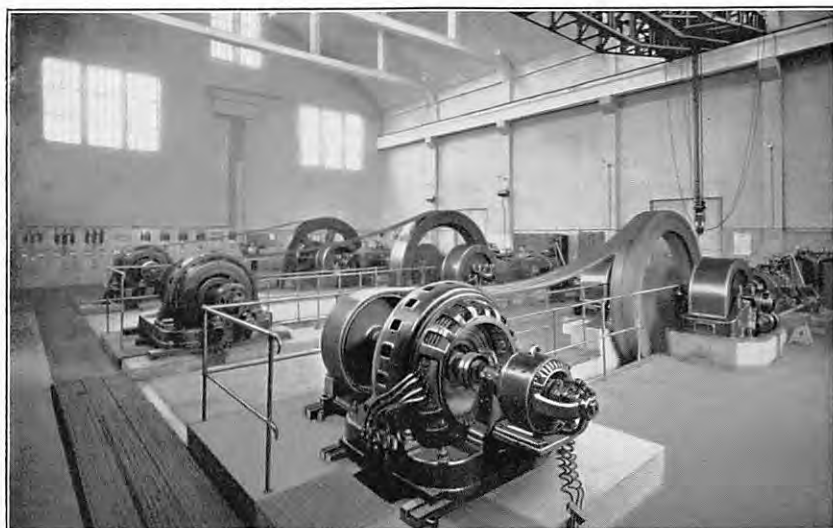
Une Centrale Électrique.
